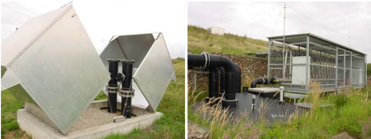
Abb. 17: Gasbrunnen mit geöffneter Abdeckung (links) und Gassammelstation auf der Deponie Wicker (rechts)
