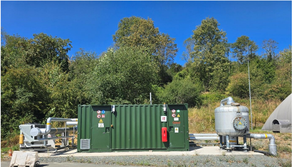
Abb. 16: Neue Deponiegasabsaugung mit Gasverdichter und Gaskühlung zur Sicherstellung einer langfristigen Deponiebesaugung am Standort Deponiepark Brandholz
