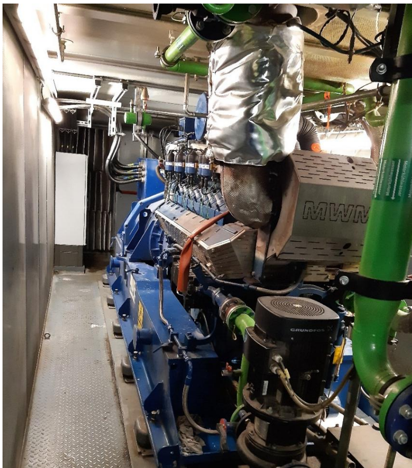
Abb. 18: Gasmotor zur Verstromung von Biogas
