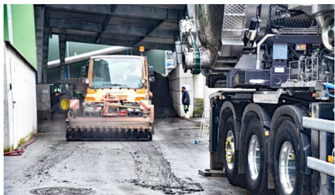
Nach jedem Leeren des Zwischenbehälters wird das Arbeitsumfeld gesäubert.
